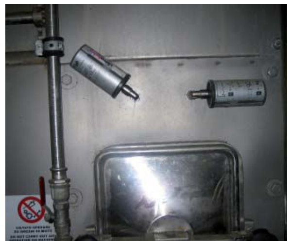
Dos BESLUX LUBE en otro lado de la instalación de lavado.
